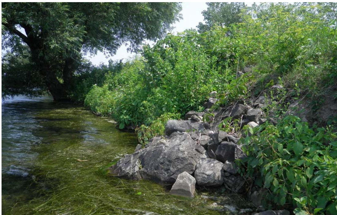
Photo 4-7 : Enrochement non végétalisé sur la rive sud du canal d'amenée, en aval de l'évacuateur désaffecté
