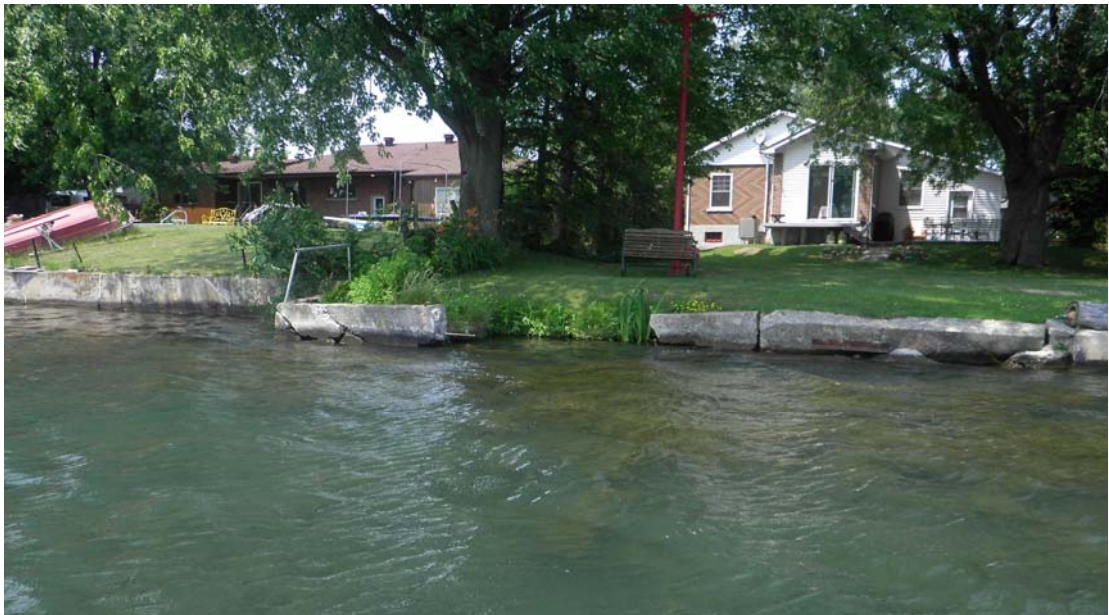
Photo 4-3 : Végétation émergente sur une section de berge non protégée sur la rive nord du canal d'amenée
