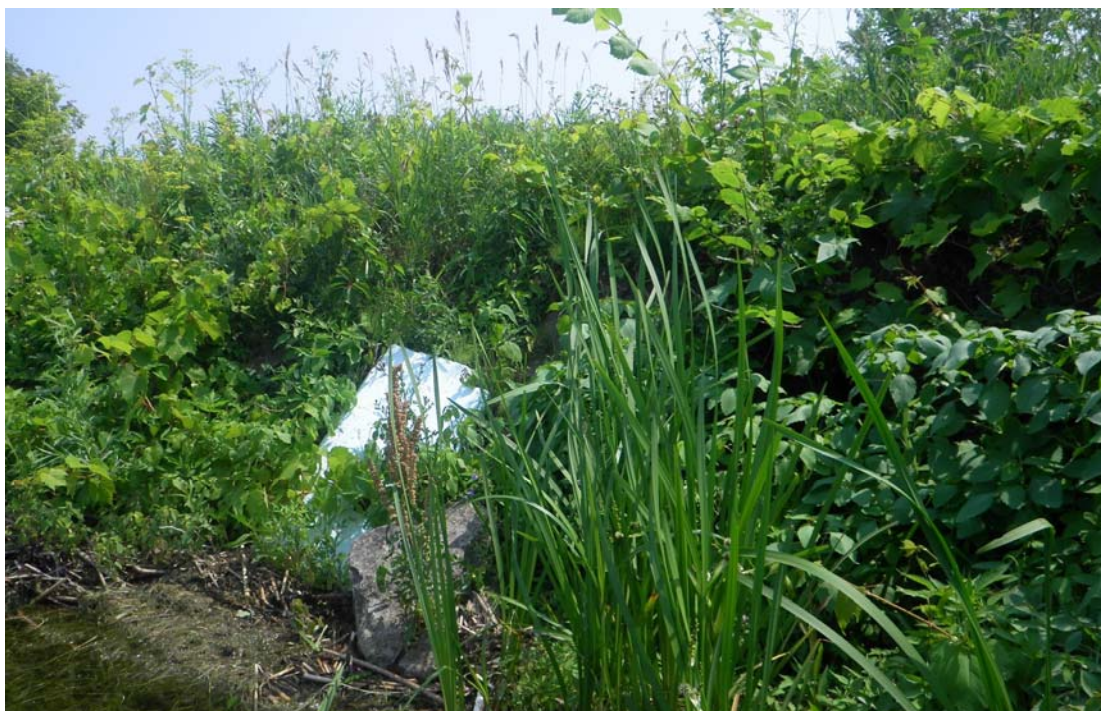
Photo 4-8 : Endroit sans enrochement sur la rive sud du canal d'amenée
