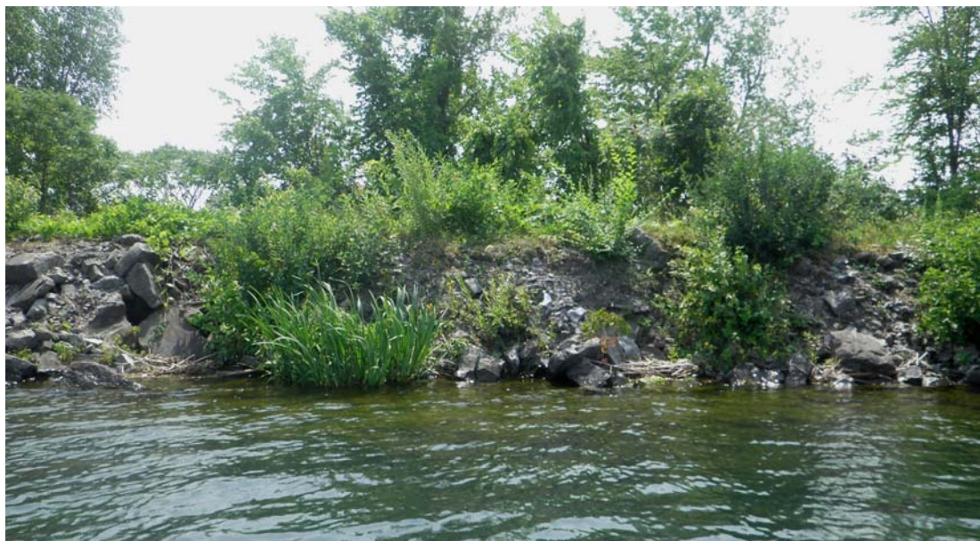
Photo 4-6 : Enrochement non végétalisé sur la rive sud du canal d'amenée, en amont de l'évacuateur désaffecté
