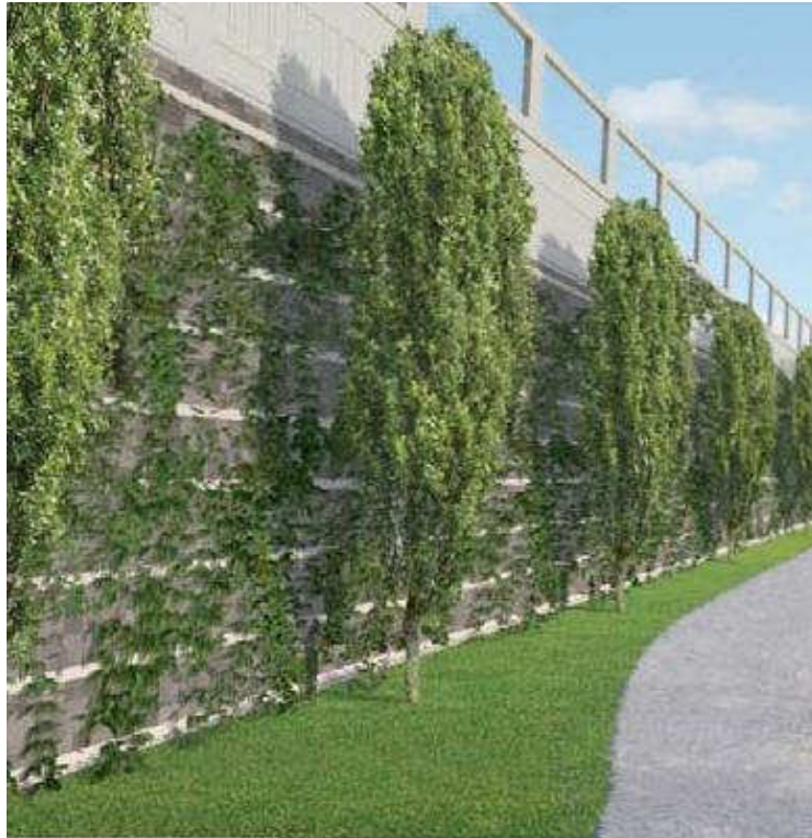
Fig. 8 Imaginons un mur de soutènement végétal de 10m bien entretenu. (Source MTQ)
