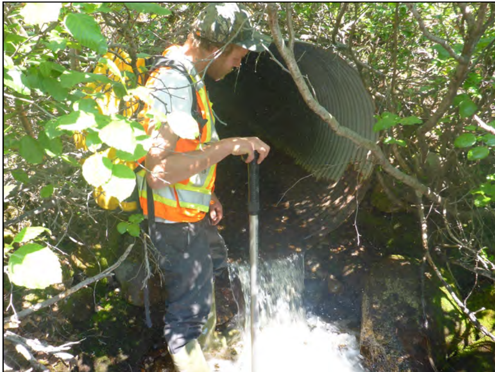
Photo 67. Ruisseau TW6 - S6 - Obstacle jugée franchissable sous réserve 26 juin 2014
