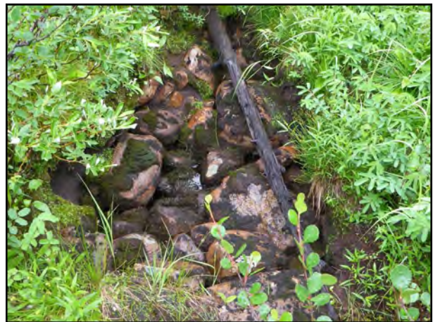
Photo 33. R141 - S2 - Écoulement au travers des blocs, obstacle infranchissable sous réserve 15 juillet 2014
