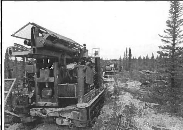
Note : Digue B+ Déplacement de la foreuse vers TF-16-03. Vue ver le Sud.
