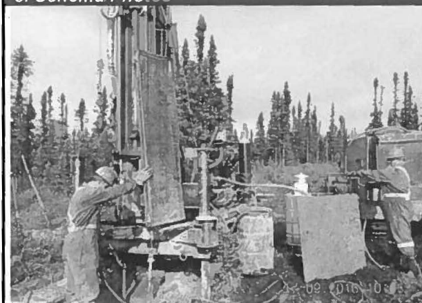
Note : Digue B+ Installation d'un puit d'observation dans le roc sur TF-16-01. Vue ver le Nord.
