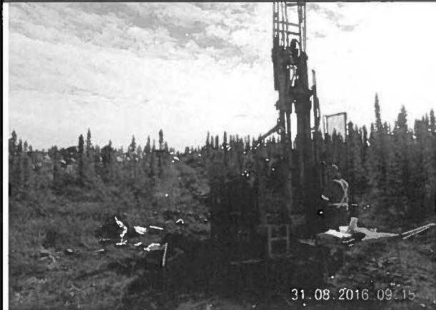
Note : Digue Hessé Digue de la Canal D'eau Rouge Forage TF-16-12, Installation de la puit d'observation. Vue ver l'Ouest
